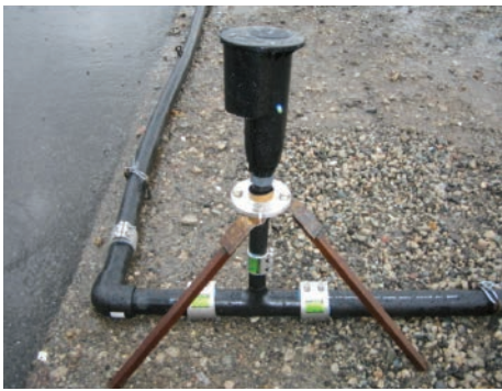
MJG EPDM 40A, 65A. sprinkler. PE pipe. Korea
